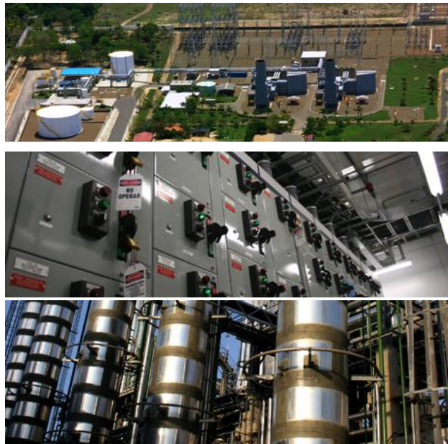
Planta electrica Termocandelaria en Cartagena.
