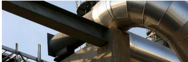
Planta electrica Termocandelaria en Cartagena.
