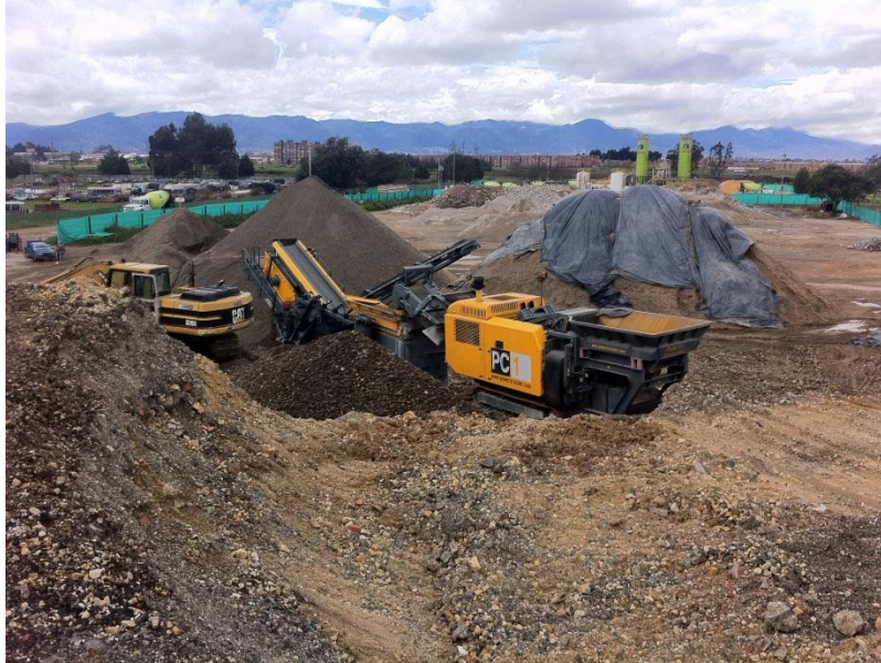
Figura 13 Equipos para el proceso de trituración.
