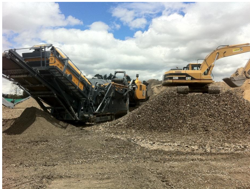
Figura 12 Equipos para el proceso de trituración.
